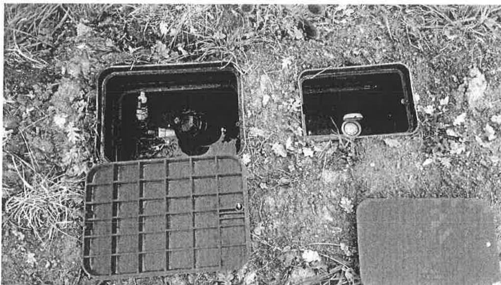
Regards de contrôle des arrivées d'eau – Novembre 2018
